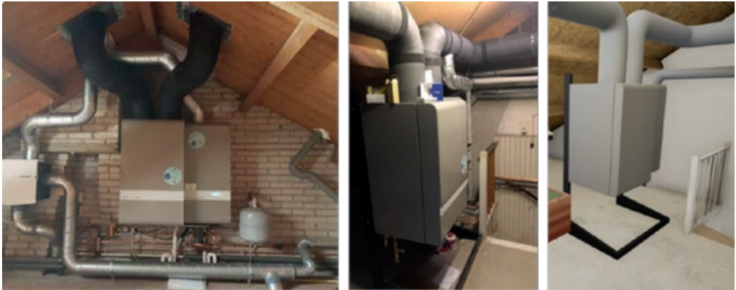
Links: warmtepomp in brochure. Midden: warmtepomp zoals achteraf gerealiseerd in modelwoning. Rechts: warmtepomp in VR
